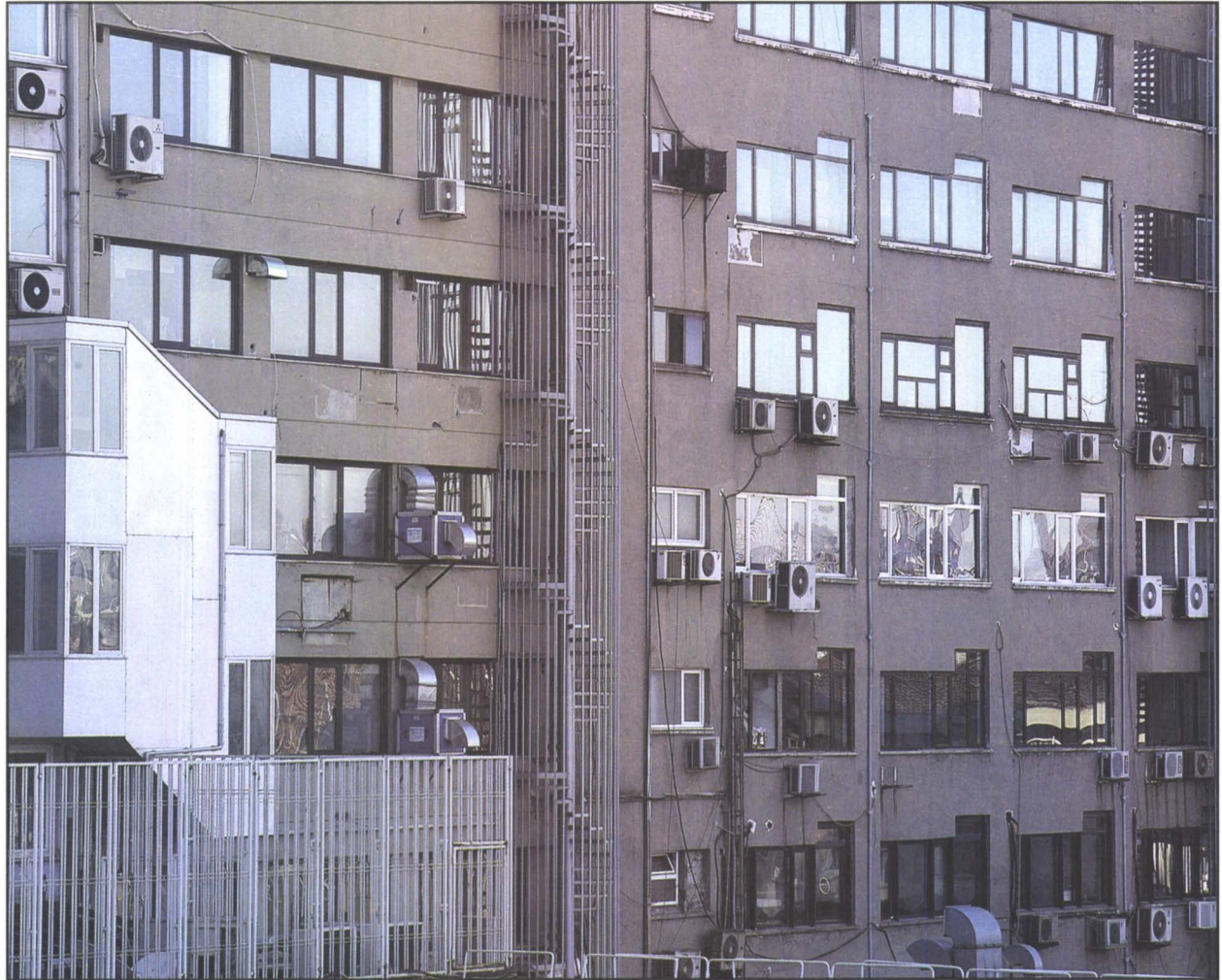
Şekil 6.103A. MİNİ SPLİT DIŞ ÜNİTE YERLEŞİMİ YERLEŞİM DAĞINIK, GÖRÜNÜM KÖTÜ, SERVİS VERMEK ZOR VE RİSKLİ.
