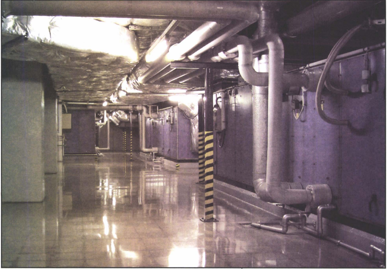
Şekil 6.5A. Sabancı Center ISI MERKEZİ KLİMA SANTRALLERİ-1
