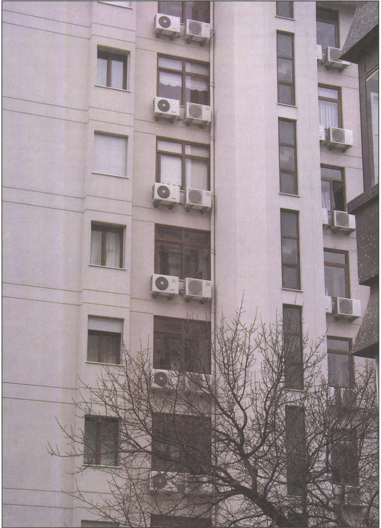
Şekil 6.103C. MİNİ SPLIT DIŞ ÜNİTE YERLEŞİMİ DÜZENLİ YERLEŞİM (SERVİS TEKNİSYENİ İÇİN RİSKLİ)
