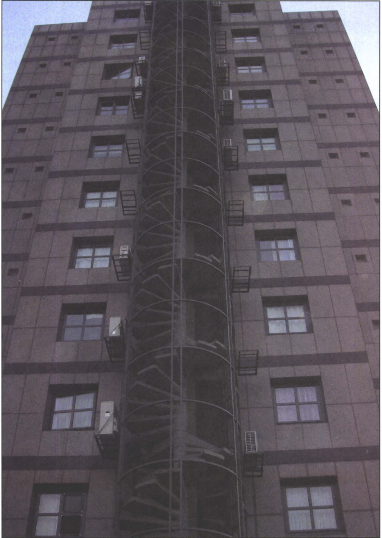
Şekil 6.110. MULTİ SİSTEM DIŞ ÜNİTE YERLEŞİM ÖRNEĞİ SERVİS TEKNİSYENİ İÇİN TEHLİKELİ. YANGIN MERDİVENİNE MONTAJ DA DOĞRU DEĞİL
