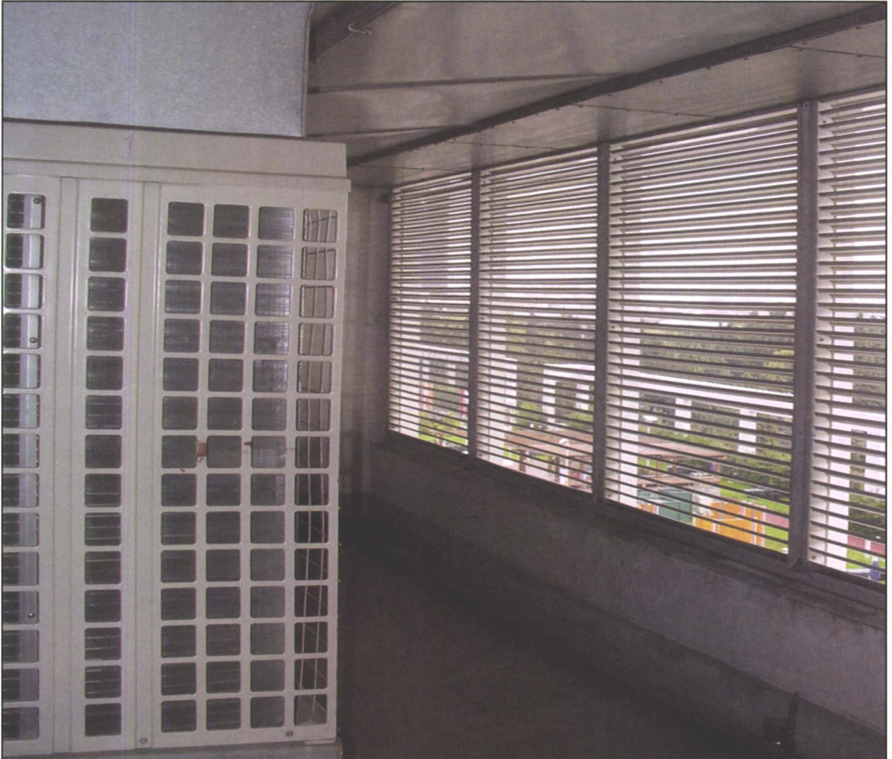
Şekil 6.147. Metrocity Residence HEAT PUMP VRV DIŞ ÜNİTELERİ (TESİSAT KATINDA, ARA KAT UYGULAMASI)
