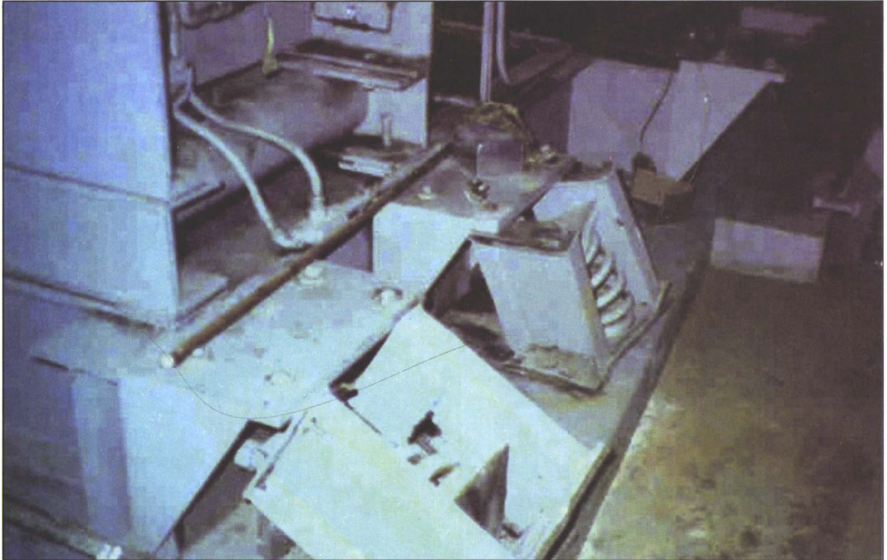
Şekil 12.8. SİSMİK İZOLATÖRLERİ YANLIŞ SEÇİLMİŞ VE YANLIŞ MONTE EDİLMİŞ (KAİDEYE BAĞLANMAMIŞ) BİR SOĞUTMA GRUBUNDA DEPREM SONRASI MEYDANA GELEN HASAR
