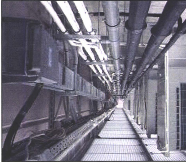
Şekil 6.66. TESİSAT GALERİSİNDEKİ DİŞ ÜNİTE UYGULAMA ÖRNEĞİ
