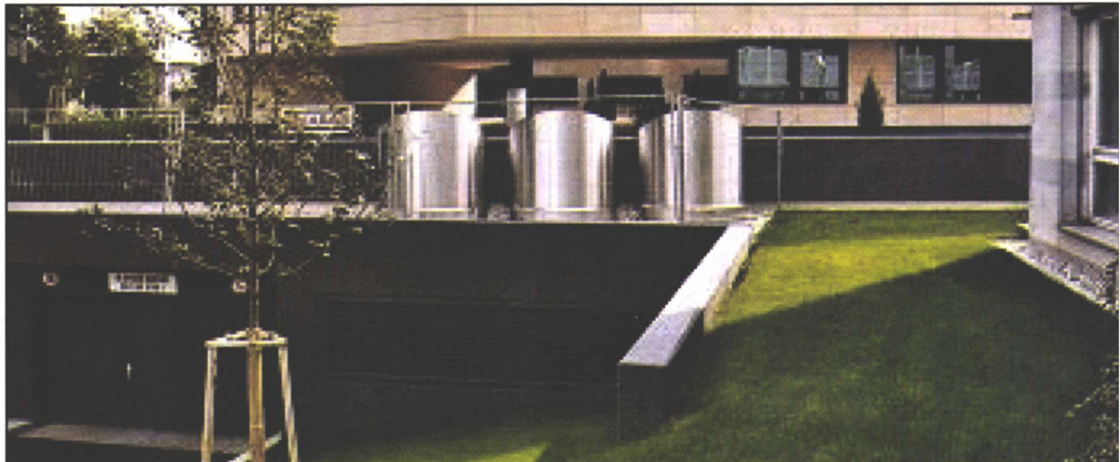
Şekil 6.69. TESİSAT MERKEZİNDEKİ DİŞ ÜNİTELERE DİŞARDAN HAVA KANALI BAĞLANTISI
